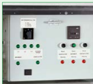
Schaltkasten mit Betriebsstundenzähler, geschützt eingebaut
